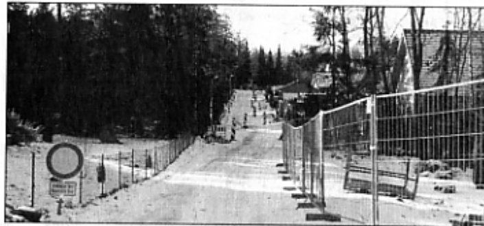
Derzeit ist der Schwalbenweg eine einzige Baustelle. Der Informationsfluß der Gemeindeverwaltung zu dieser Maßnahme gegenüber den Anwohnern scheint ins Stocken geraten sein Foto: jr
